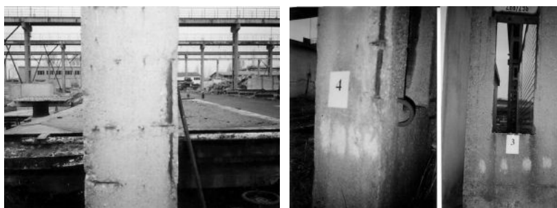
Rys. 4 Skorodowane zbrojenie Fig. 4 Corroded concrete reinforcement
